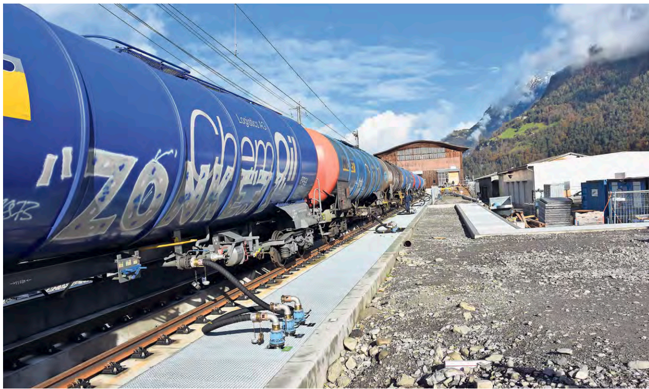
Die acht Kesselwagen mit total 640 000 Liter Inhalt auf der neuen Entladeanlage. In 2½ bis 3 Stunden sind die Wagen komplett leergepumpt. FOTO: MARKUS ARNOLD
